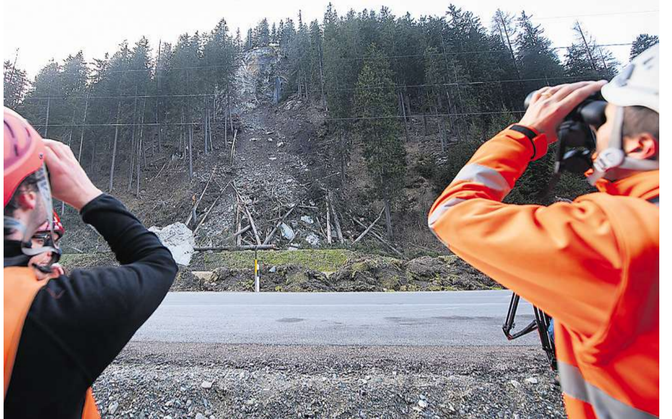
Der Fels ist unten: Nach erfolgter Sprengung begutachten Mitarbeiter des Tiefbauamts Graubünden den Nascharegnas-Hang über der Julierstrasse.
